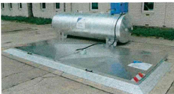
Die geschlossene Eigenverbrauchs-Tankanlage (Außenaufstellung)
